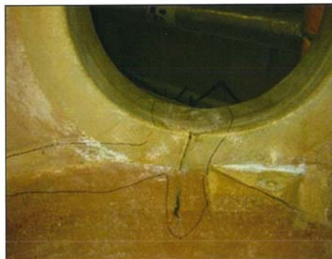
補修前（亀裂部）
