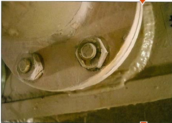
リークチェック (漏油箇所の確認)
