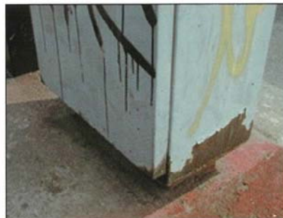
施工前腐食状況
