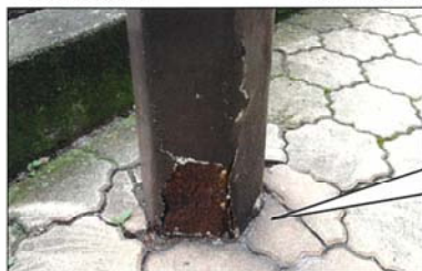
ウルトラパッチ破断状況
