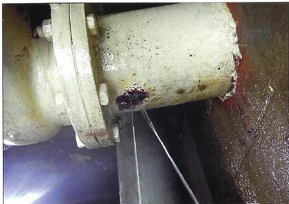
補修前（漏水状態）
