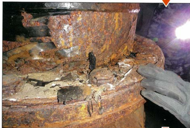
補修前 (フランジ部腐食状況)
