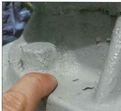
ガス漏れ状況
